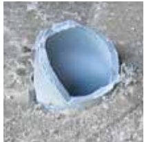
Broken conduit on jobsite
